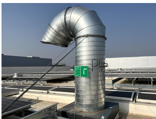
焊装车间电弧焊烟尘排气筒标识
