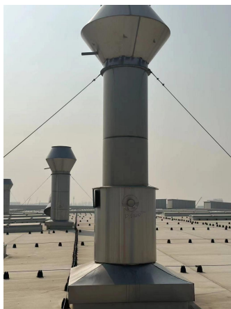
电泳废气排气筒
