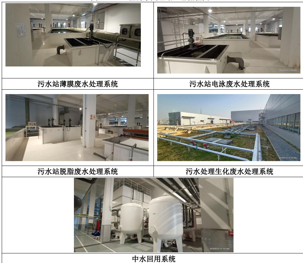
图4.1-3 废水处理措施照片
