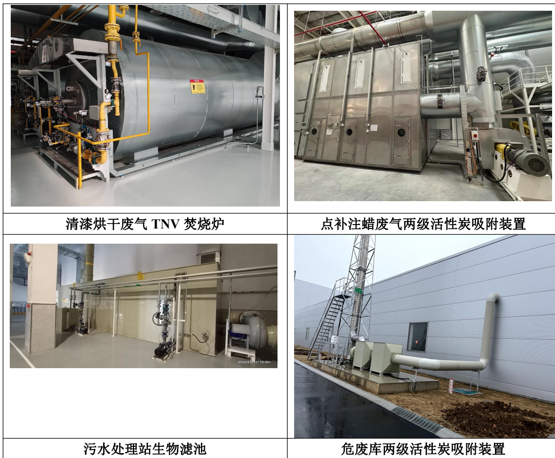
图 4.1-4 废气治理措施照片
